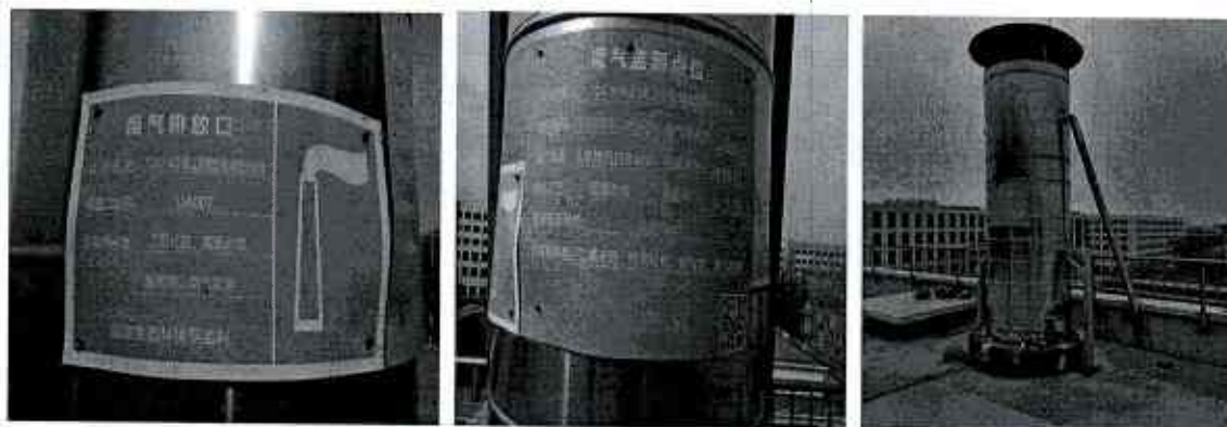
图 4-2 废气排放口及标识牌
